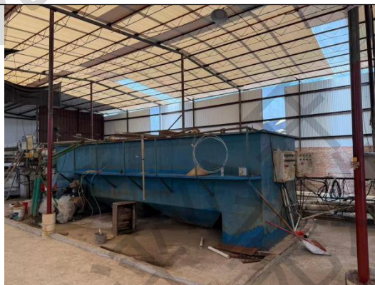
污水处理设施
