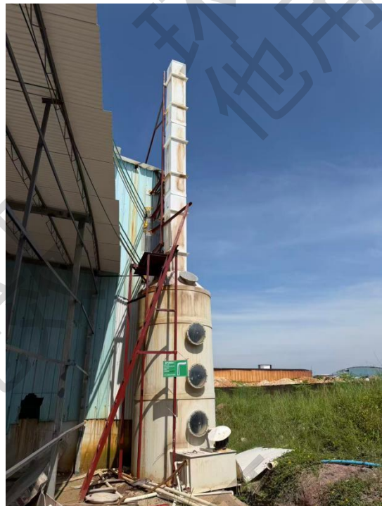
酸雾喷淋塔及排放筒
