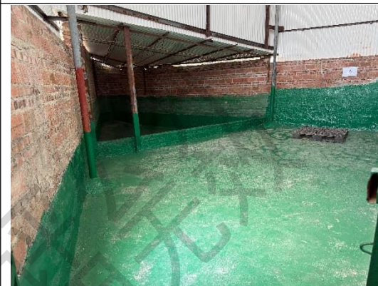
一般固体废物暂存间
