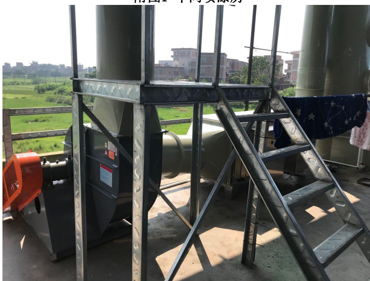
附图2 有机废气处理设施监测平台
